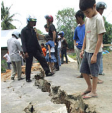
Ein Riss geht nach einem Erdbeben am 13. September 2007 durch Bengkulu auf Sumatra. Foto: AP
